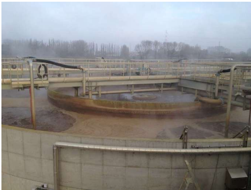
Figuur 8-15 Overzicht aerob zuiveringsgedeelte
