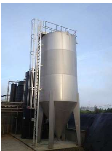
Figuur 8-17 Zandfilter voor fosfaatprecipitatie en denitrificatie
